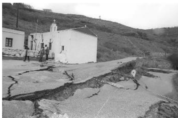
Εικόνα 2. Τήνος. Κατεστραμμένο οδικό δίκτυο Figure 2. Tinos island. Destroyed road network.
